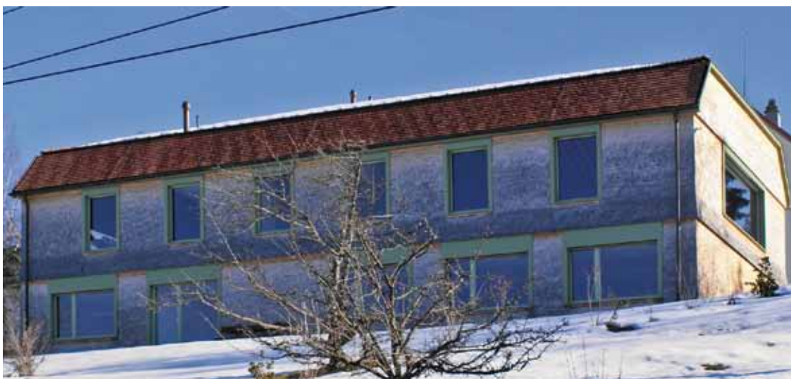
So präsentierte sich die umstrittene Fassade des Kirchgemeindehauses Hörli anfangs Januar 2012. Foto: Paul Grunder
